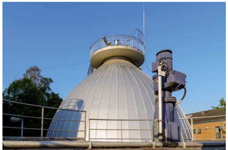
Kläranlage Hückeswagen, Faulbehälter
